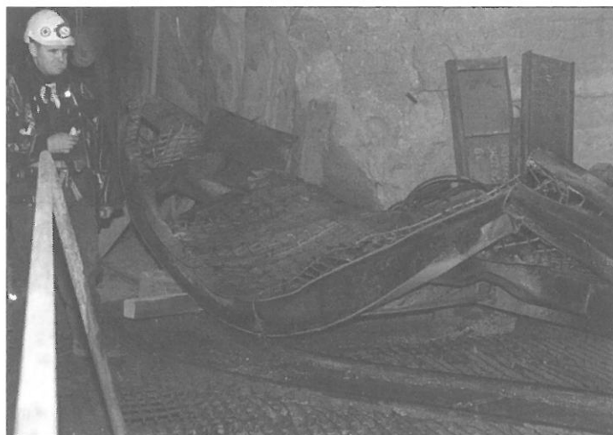
Křídlo roštového poklopu po uvolnění.
