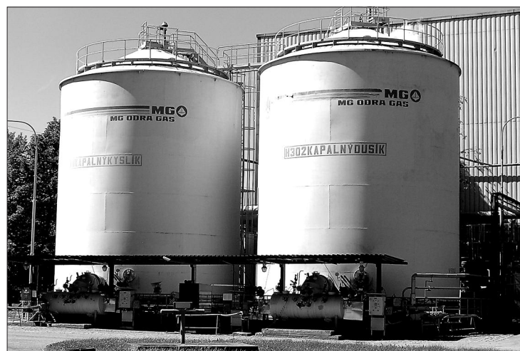
Obr. 5 Zásobník kapalného dusíku v prostorách MG Odra Gas, s.r.o.
