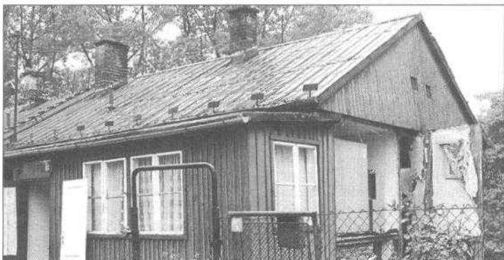
VYRAŽENÁ STĚNA DOMKU PO VÝBUCHU „NA LIŠČINĚ“
