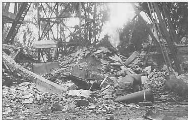
▲ ÚSTÍ JÁMY He III V OSTRAVĚ-HEŘMANICÍCH PO VÝBUCHU 30. 6. 1998
