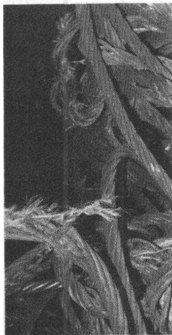
HAVAROVANÉ LANO VE SVISLÉM DÍLE
